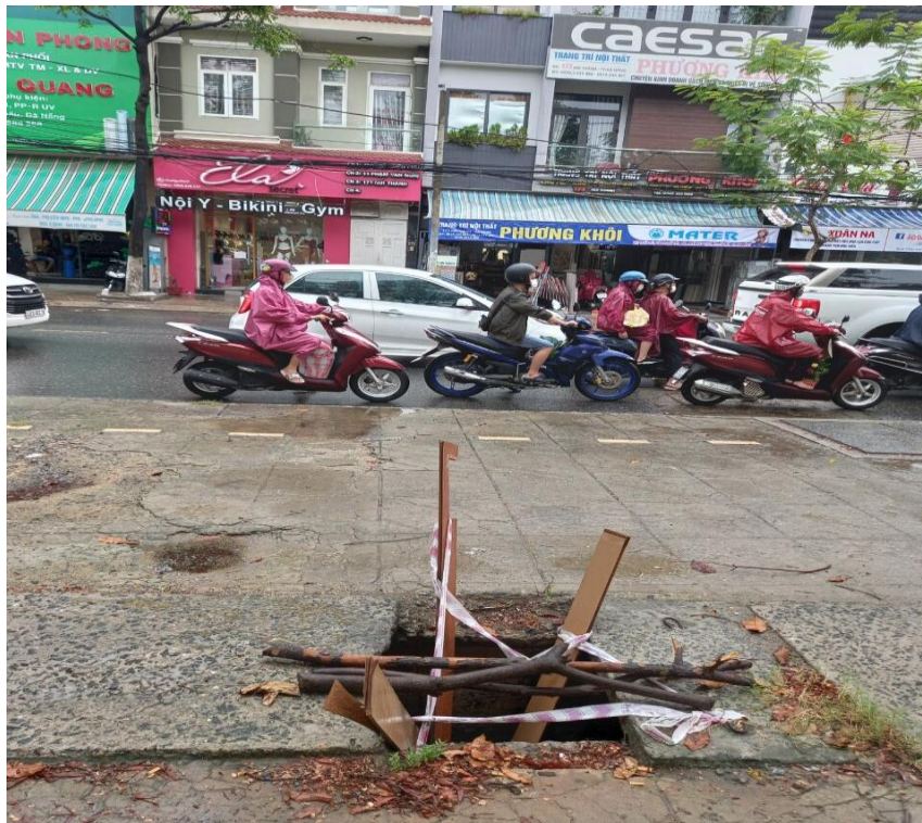
Hình ảnh trước xử lý tại hố ga bị vỡ trước số 171 đường Núi Thành
