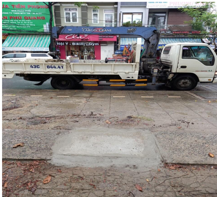
Hình ảnh sau xử lý tại hố ga bị vỡ trước số 171 đường Núi Thành
