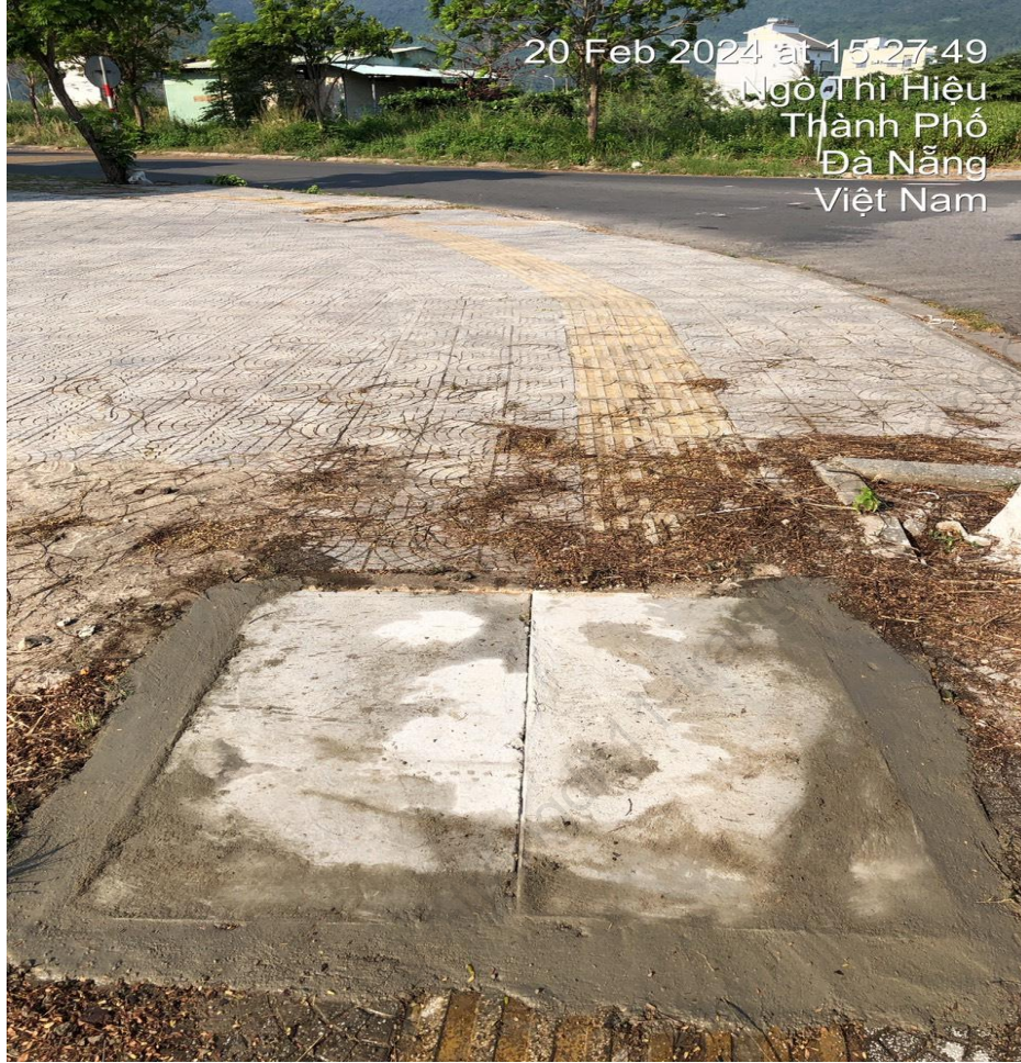
Hình ảnh sau xử lý đan võ trên vỉa hè trước lô 5,6 đường Lê Đức Thọ
